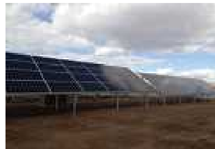
太陽光パネル
