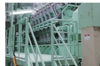
ガスコジェネレーション・冷凍機 (タイ) /関西電力
