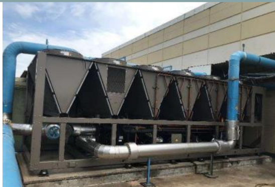
設置された省エネ型チラー
