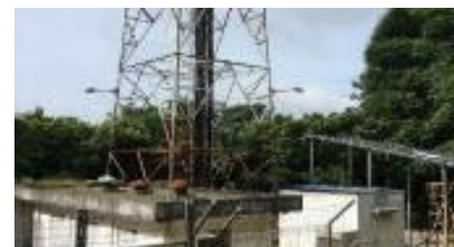
携帯電話基地局へのトライブリッド 技術導入(インドネシア) /KDDI
